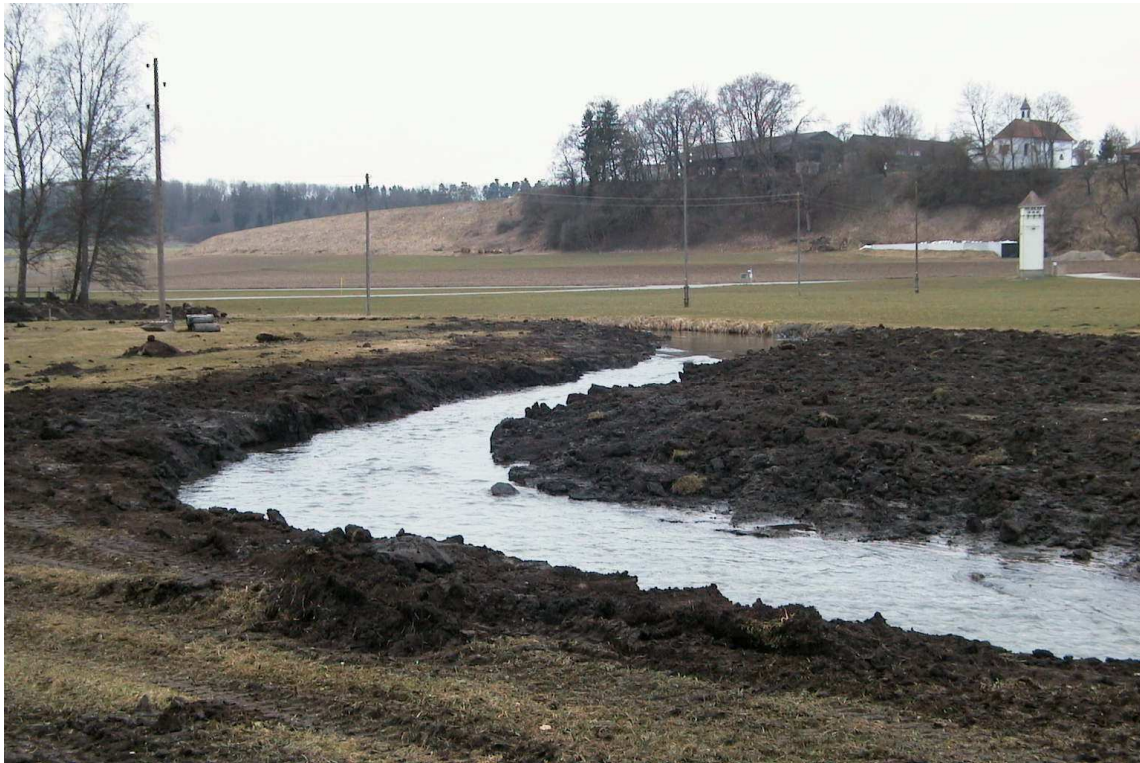
Das Bild zeigt einen 2011 künstlich geschaffenen Mäander im Bereich der ehemaligen Dotschenmühle (flussaufwärts fotografiert) nach Abschluss der Baggerarbeiten. Rechts davon entsteht eine Hochstaudenfläche.
