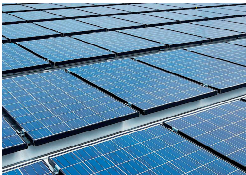
Abb. 17 : Photovoltaik (Quelle: https://www.voss-gebauetechnik.de/gewerbekunden/anlagenbau/photovoltaik.html )
